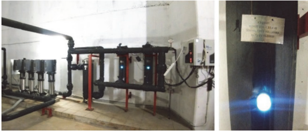
Slika 8. UV sustav za pročišćavanje kišnice
