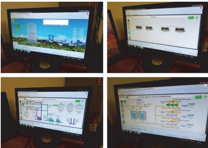
Slika 10. Sustav automatiziranog kontrolnog centra zgrade
