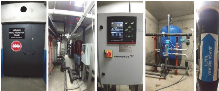
Slika 9. Prostorija za pročišćavanje kišnice i sustave
